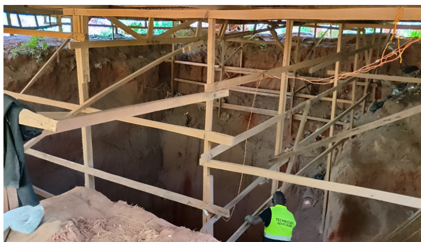
◀ Puits minier à Kamilombe protégé par une structure en ossature bois.
