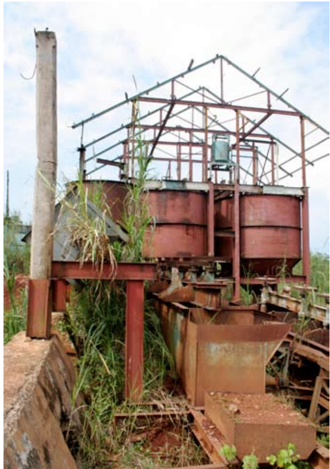
Usine SOKIMO ruinée sur les mines d'or de Mongbwalu (IPIS, 2009)
