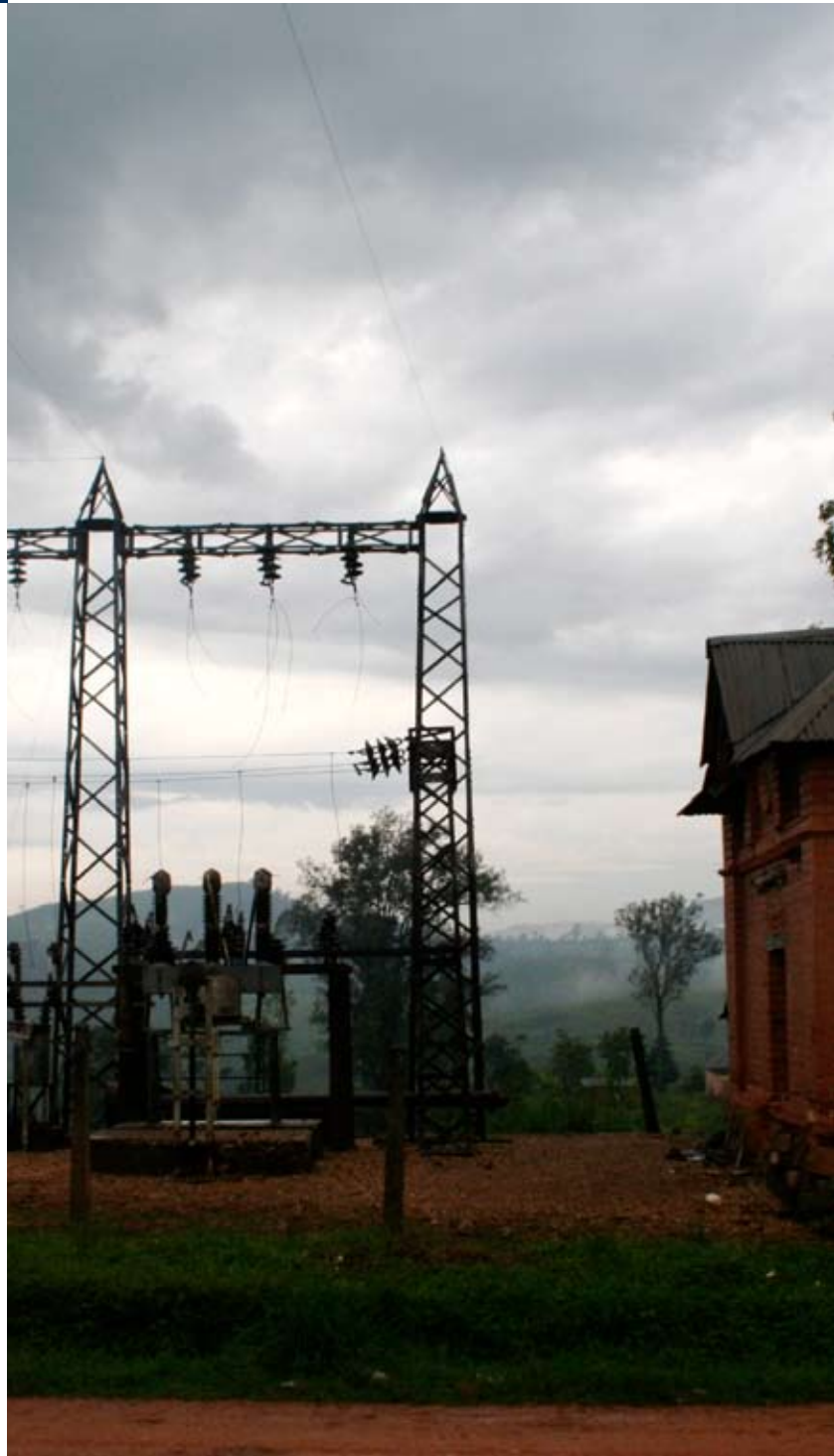
Elektriciteitscentrale nabij Bunia (Foto: IPIS)
