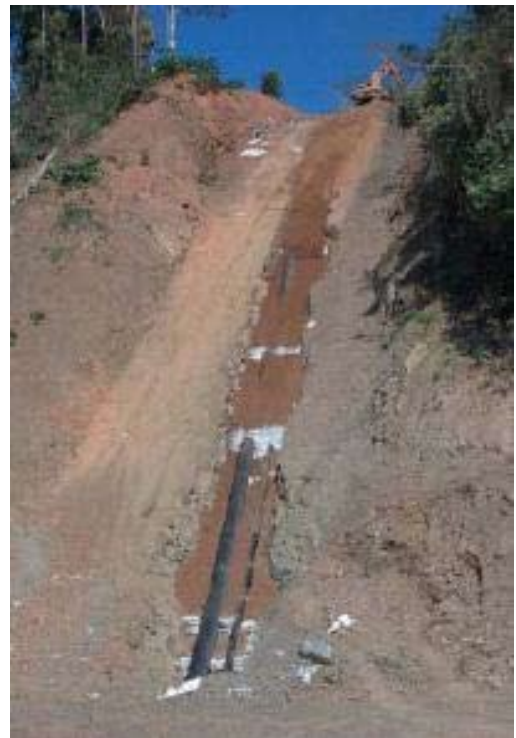
Foto-credit © E-tech, 2007. Uit Camisea Pipeline Ruptures and Audit, 14 – 15 februari 2007.
